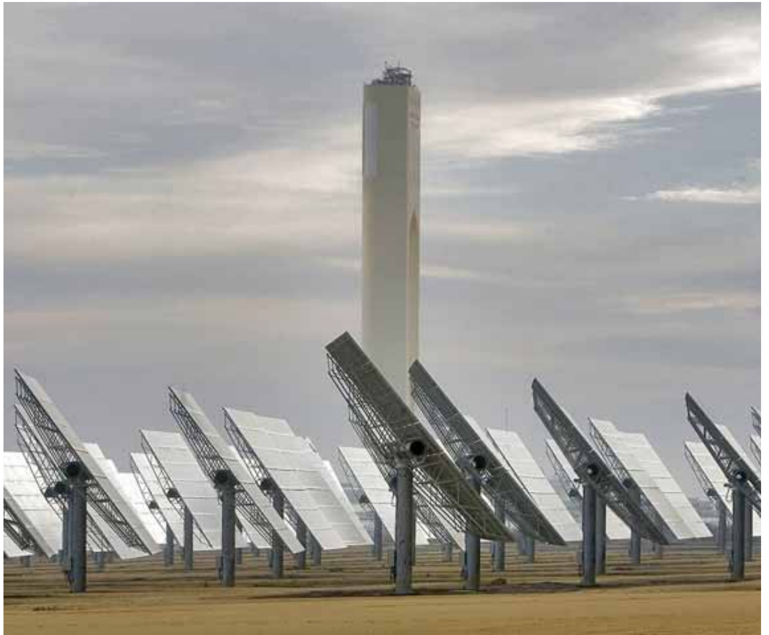
Vista de las instalaciones solares construidas por Abengoa en el municipio sevillano de Sanlúcar La Mayor.
