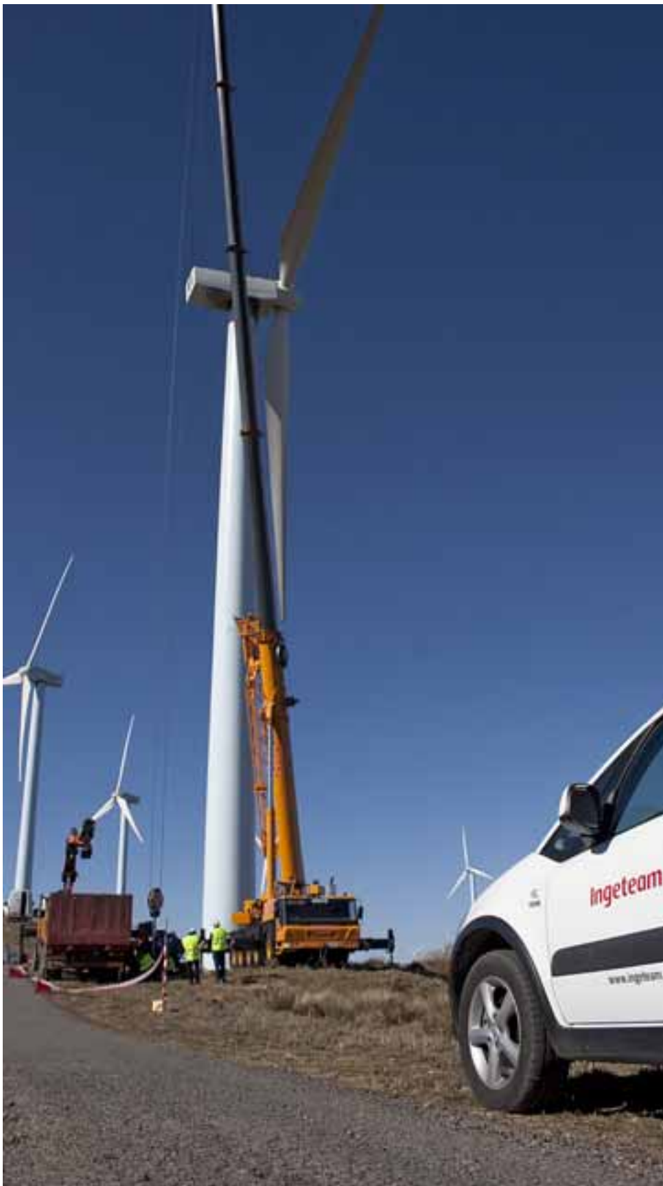
Operarios de la firma vizcaína Ingeteam realizan labores de mantenimiento de aerogeneradores.
