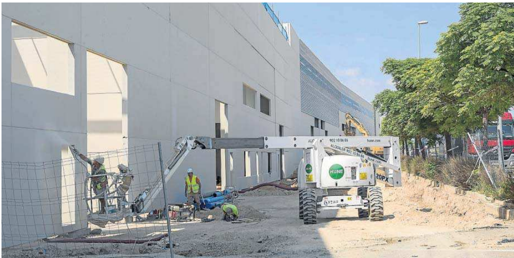
Un grupo de operarios trabajaban en la fachada de la nave del grupo Bancalé, el pasado miércoles. GUILLERMO MESTRE
