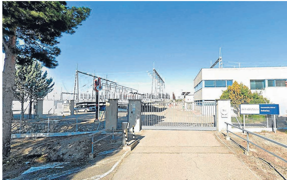
Subestación Peñaflor, situada en Villamayor de Gállego, de la que dependía el ‘enchufe’ de 50 megavatios concedido a Iberdrola, al que ha renunciado tras no alcanzar un acuerdo para un centro de datos. GOOGLE MAPS
